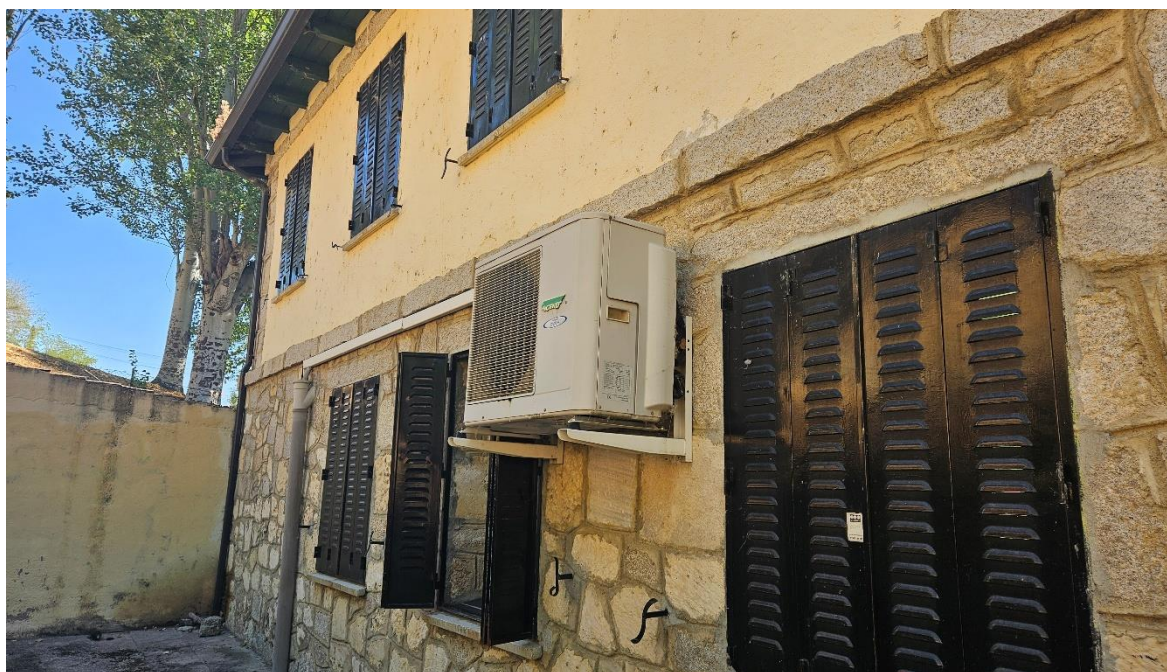
UNIDAD EXTERIOR DE CLIMATIZACIÓN
