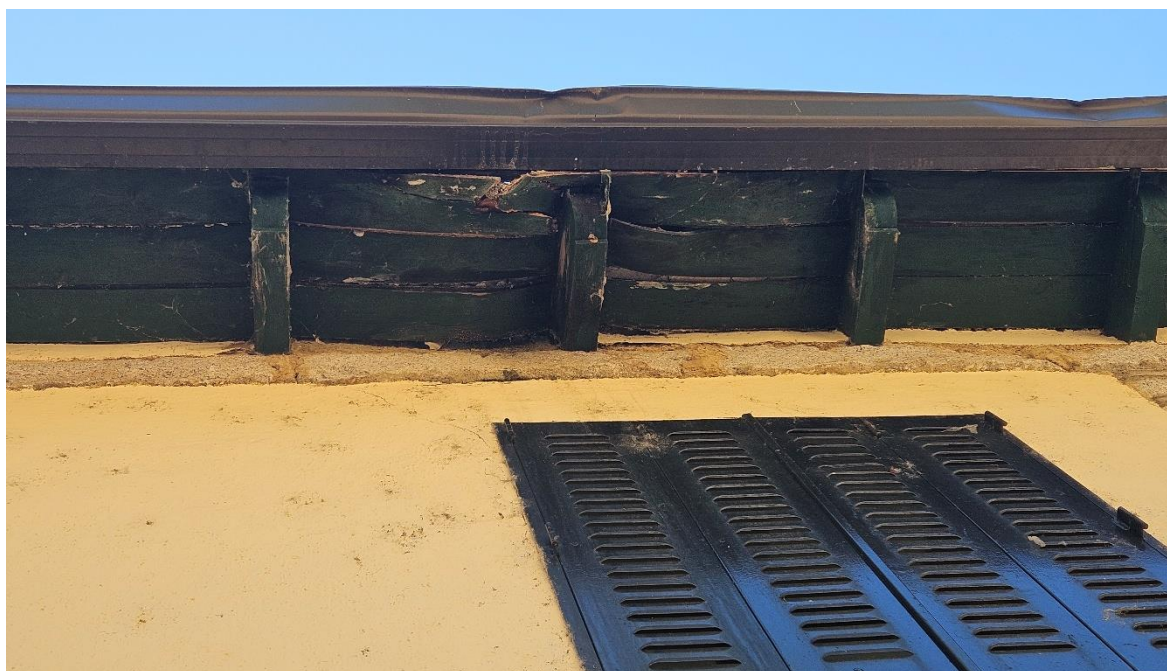
ALERO CON DAÑOS POR AGUA
