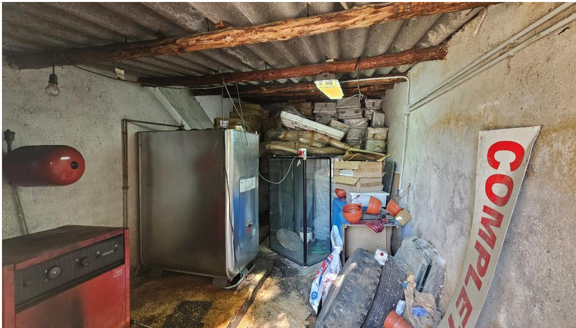
ALMACEN DE INSTALACIONES Y CALDERA DE GASOIL
